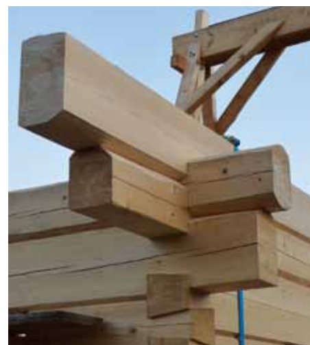
Vodorovné výsušné trhliny v prizmách
